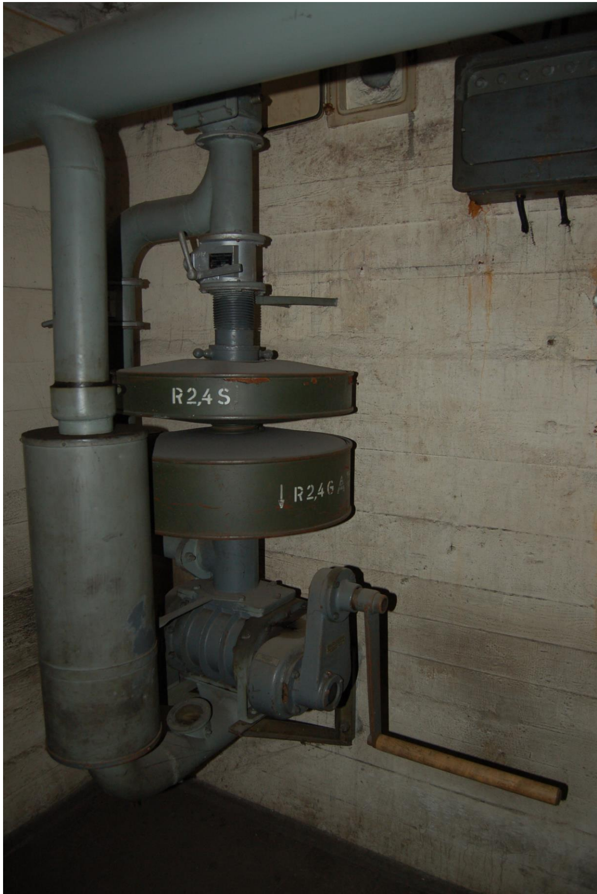
Abb. 21: Lüfter mit Handkurbelbetrieb, die Kennziffer „2,4“ auf den Aktivkohlefiltern steht für das Filtervolumen von bis zu 2,4 Kubikmeter Durchsatz pro Minute
