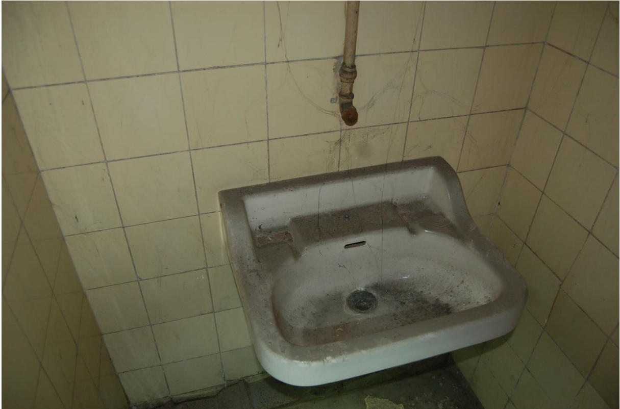
Abb. 18: Waschbecken aus Porzellan; der Wasserhahn wurde demontiert
