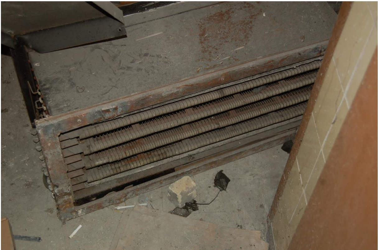
Abb. 19: elektr. Luftheizelement in einem Sanitärraum, vermutlich ein Wickelraum
