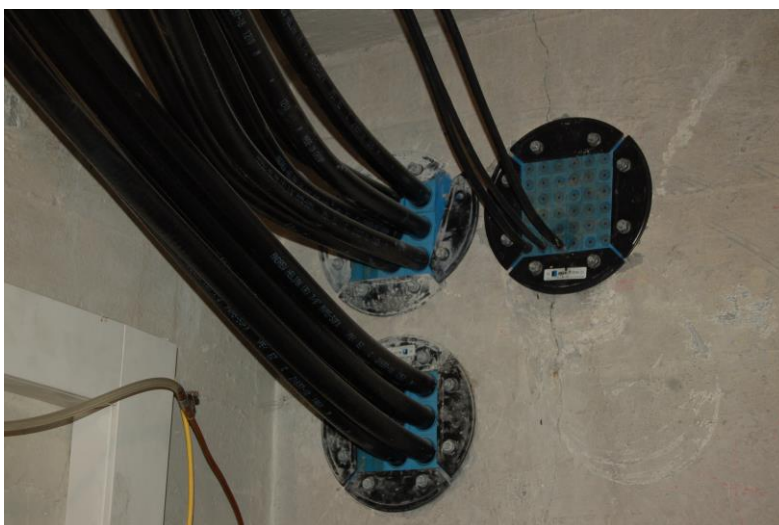
Abb. 28: Doppeldichtpackungen mit Kabeldurchführungen durch die östliche Bunkeraußenwand (Kernbohrungen) zu den Antennenmasten
