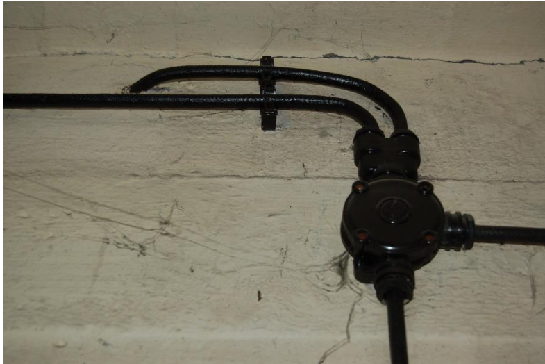
Abb. 24: Aufputz-Verteilerdose aus Bakelit und textilummantelte und bitumenbeschichtete Leitungen
