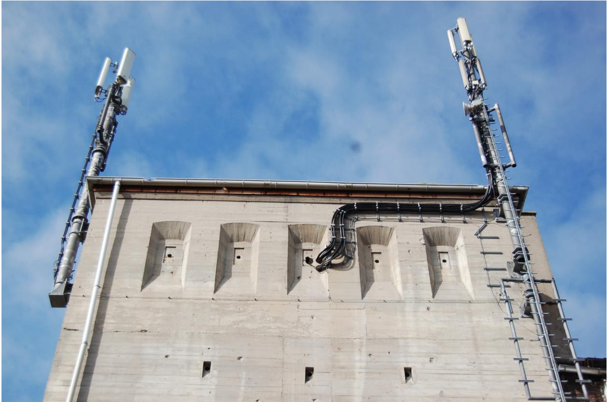
Abb. 29: zwei der drei an den Fassaden befestigten Sendemasten der Basisstationen
