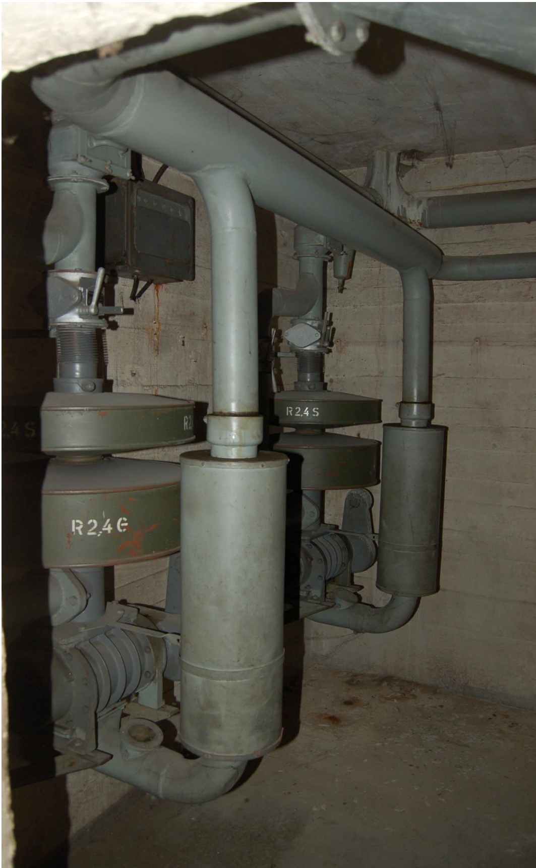
Abb. 20: Blick auf einen Teil der Lüfteranlage in Raum 30 in der Mitte die vier Filter, unten die Luftförderer, im Vordergrund in den beiden Frischluffleitungen die Konstantvolumenregler
