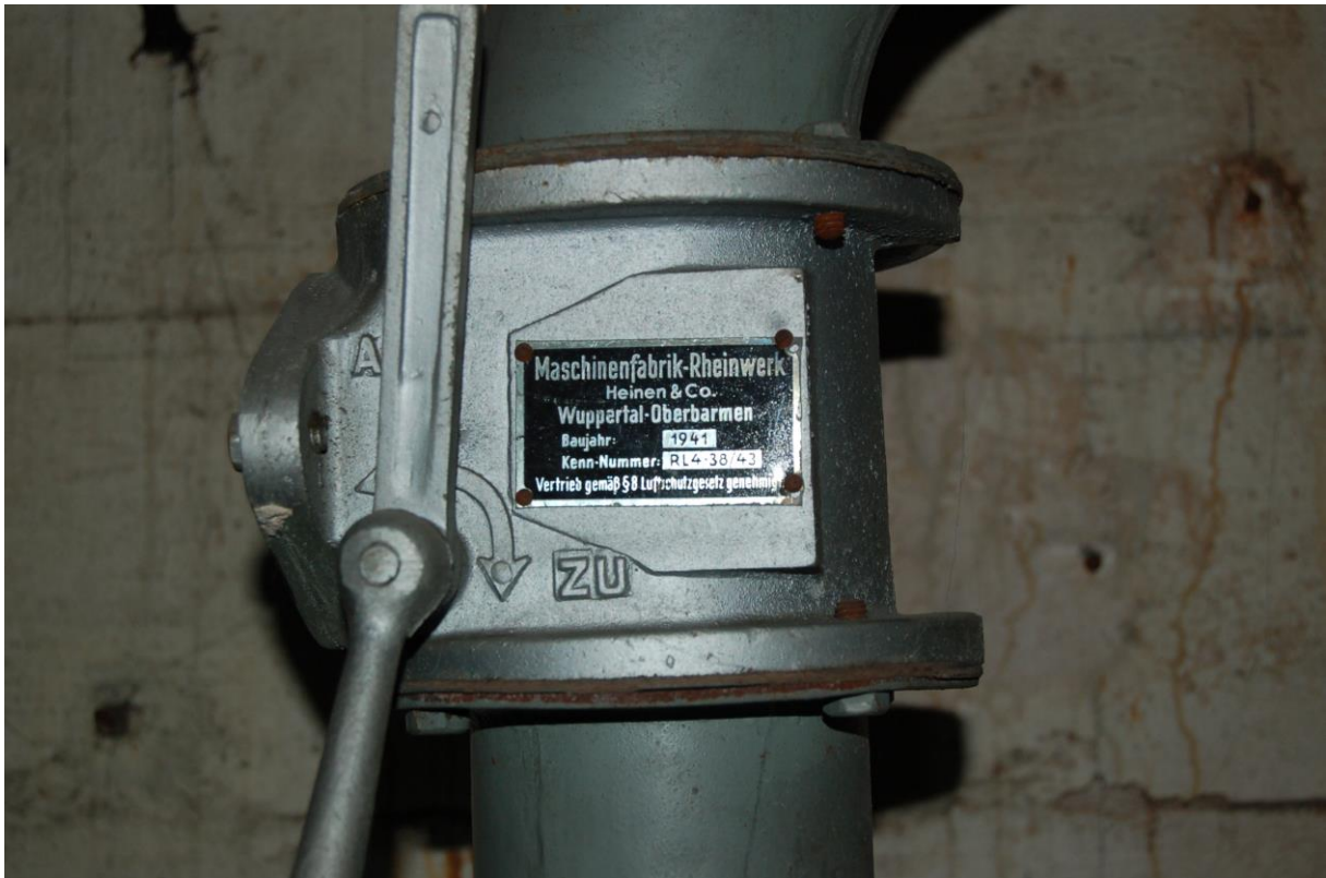
Abb. 22: eines der beiden Umschaltventile von Normalluftbetrieb auf Schutzluftbetrieb, Fabrikat Maschinenfabrik-Rheinwerk Heinen & Co. mit RL-Kenn-Nummer 4-38/43
