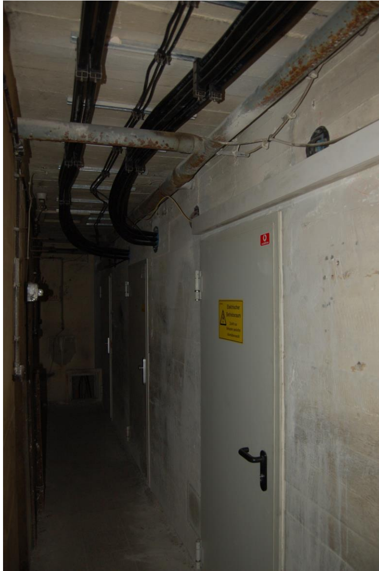
Abb. 27: drei der vier Räume, die jetzt mit Mobilfunktechnik belegt sind
