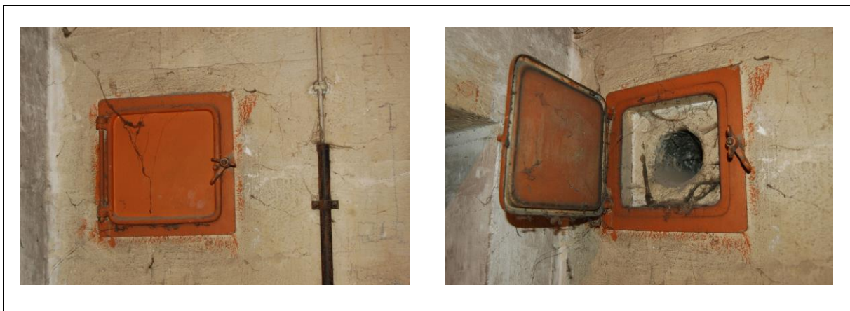
Abb. 09: zusätzliche Luftklappen für einen Umluftbetrieb
