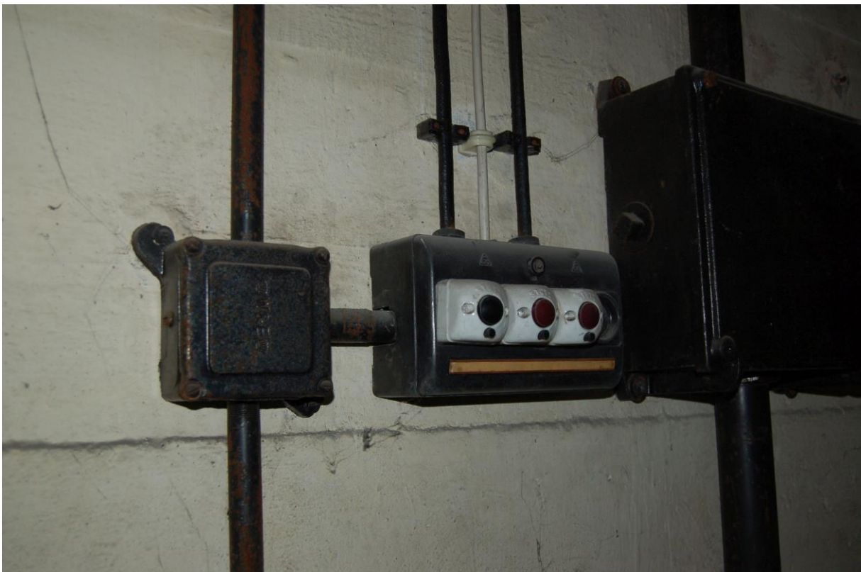
Abb. 07: originale Elektroinstallation mit einer neuzeitlich eingelegten Lichtleitung
