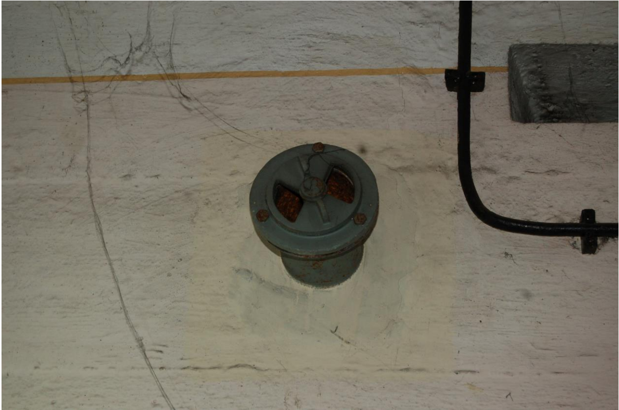
Abb. 11: Frischluftarmatur in einem Schutzraum, rechts oben die Abluftöffnung (man beachte den ockerfarbenen aufgemalten Zierstreifen)
