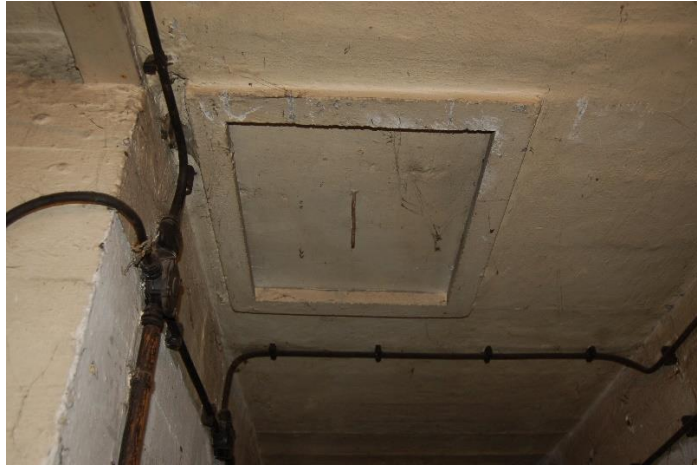
Abb. 15: Revisionsklappe zum Abluftkanal in der Hohldecke
